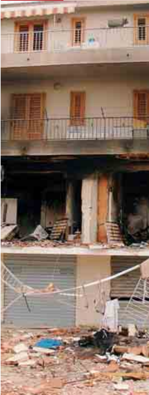
UNA DELLE PALAZZINE SVENTRATE DALL'ESPLOSIONE
